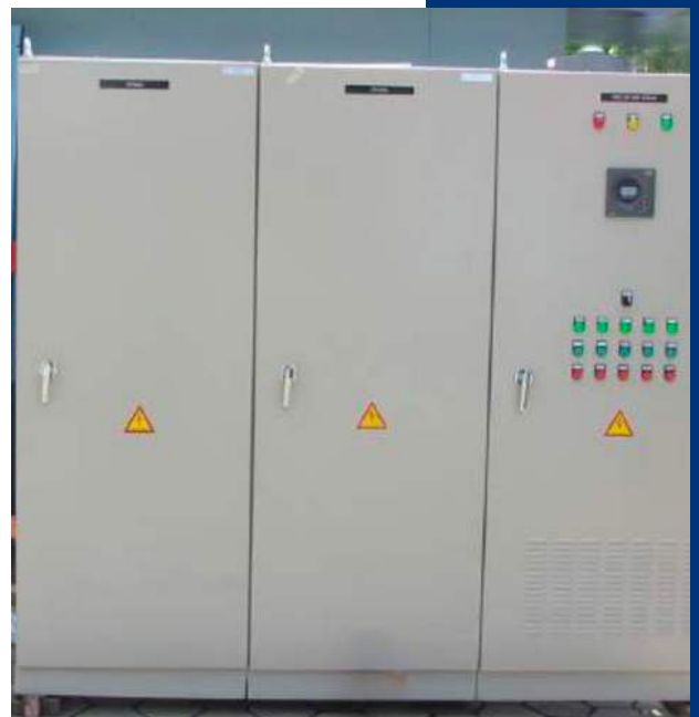
LVMDP Control Panel at Stasiun Pengisian dan Pengangkutan Bulk Elpiji (SPBE) Setu Project
